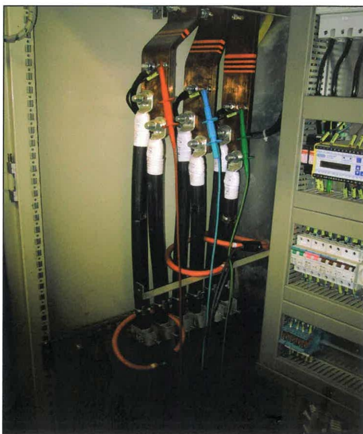
Obr. 2 Napájecí síť 690 V za měničem, vývod na elektromotory
