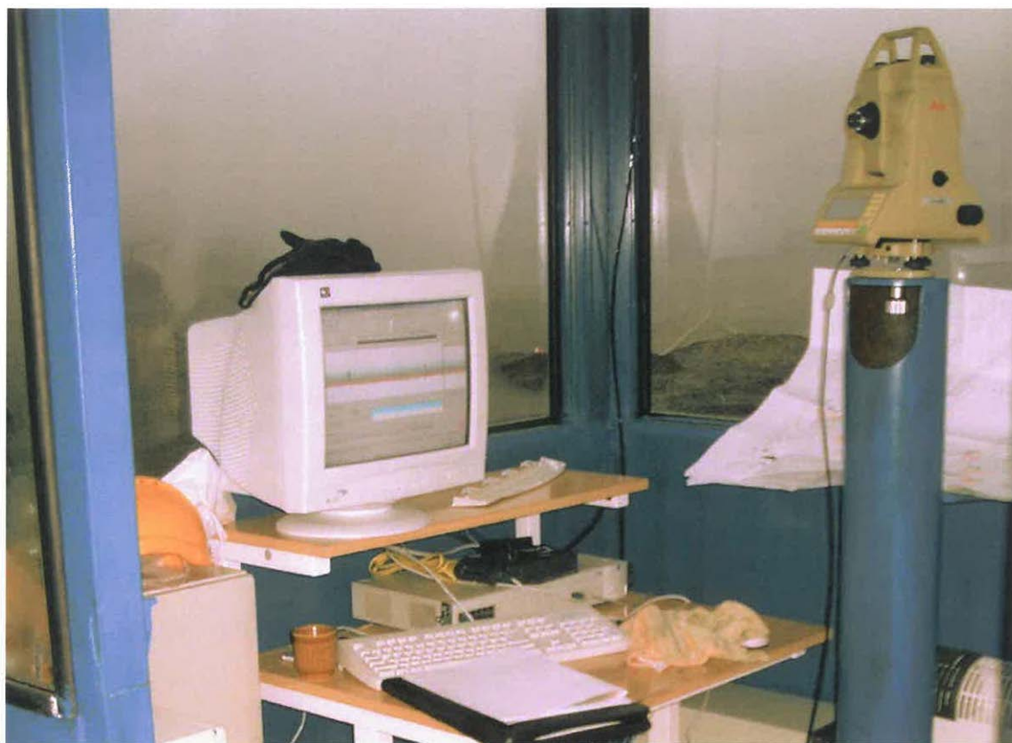
Obr. 5 Monitorovací buňka – vnitřek
