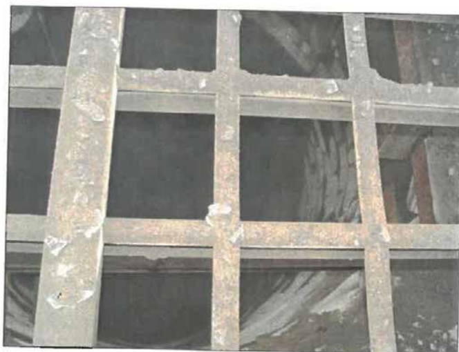
Obr. 2: Pohled na jámový stvol přes instalovaný zásypový rošt
