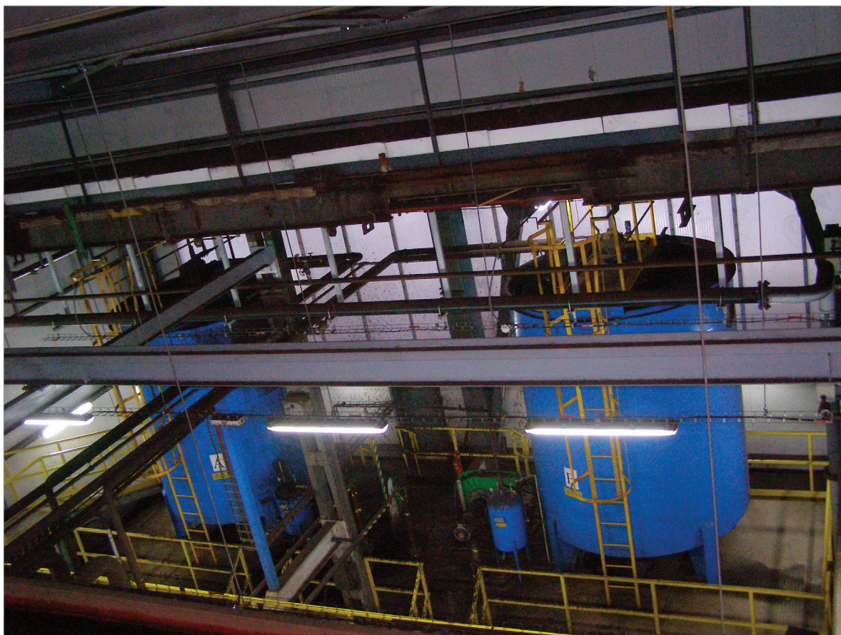
Obr. 5: Zahušťovací nádrže kalů.
