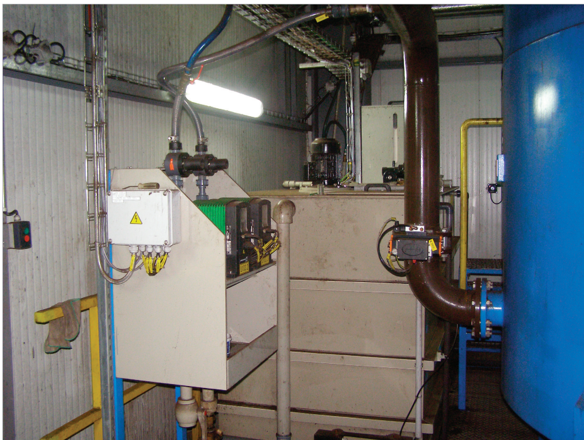
Obr. 2: Celoplastová zásobní nádrž, dávkovací čerpadla, zásobník na polymer.
