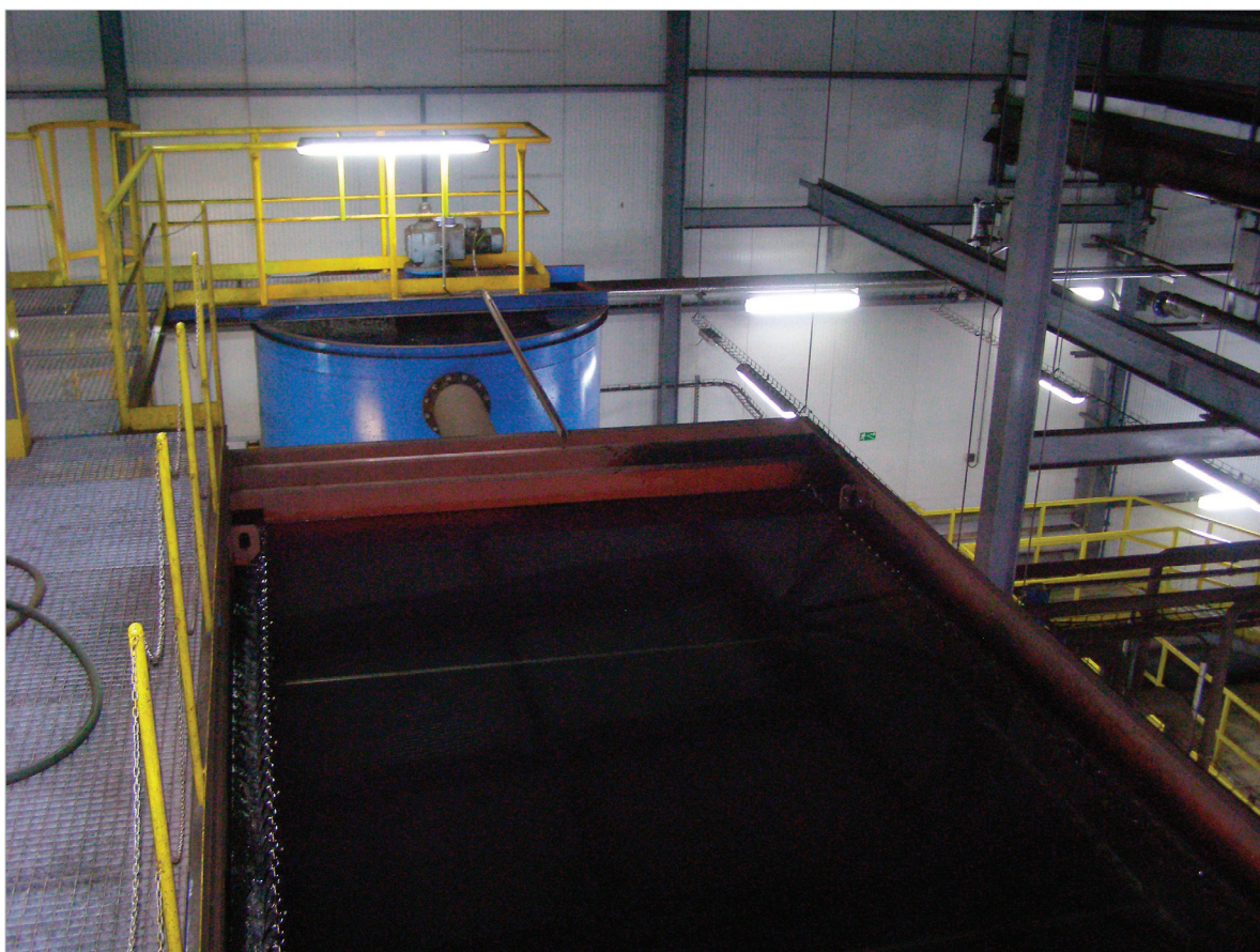
Obr. 3: Přepad čisté vody z lamelové usazovací nádrže.
