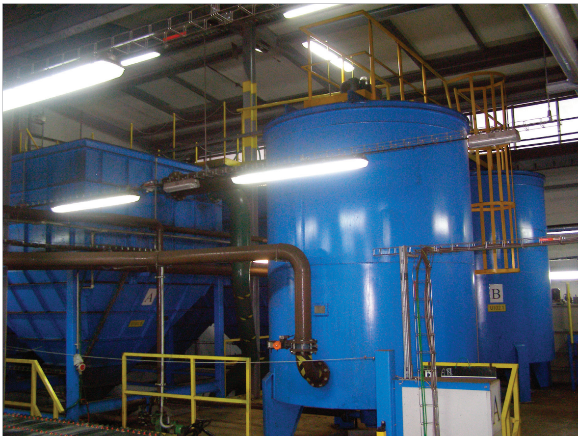
Obr. 1: Flokulační komory, lamelové usazovací nádrže.
