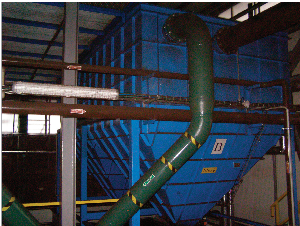
Obr. 4: Usazování kalů ve spodní jehlanovité části lamelové usazovací nádrže.
