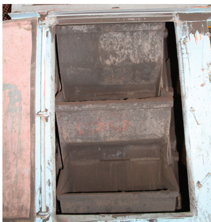
Obr. 2: Kontrolní otvor korečkového elevátoru.
