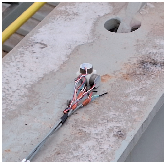
Obr. 8: Umístění akcelerometrů Seika B2 pro snímání zrychlení horního pásu vyvažovacího výložníku.
