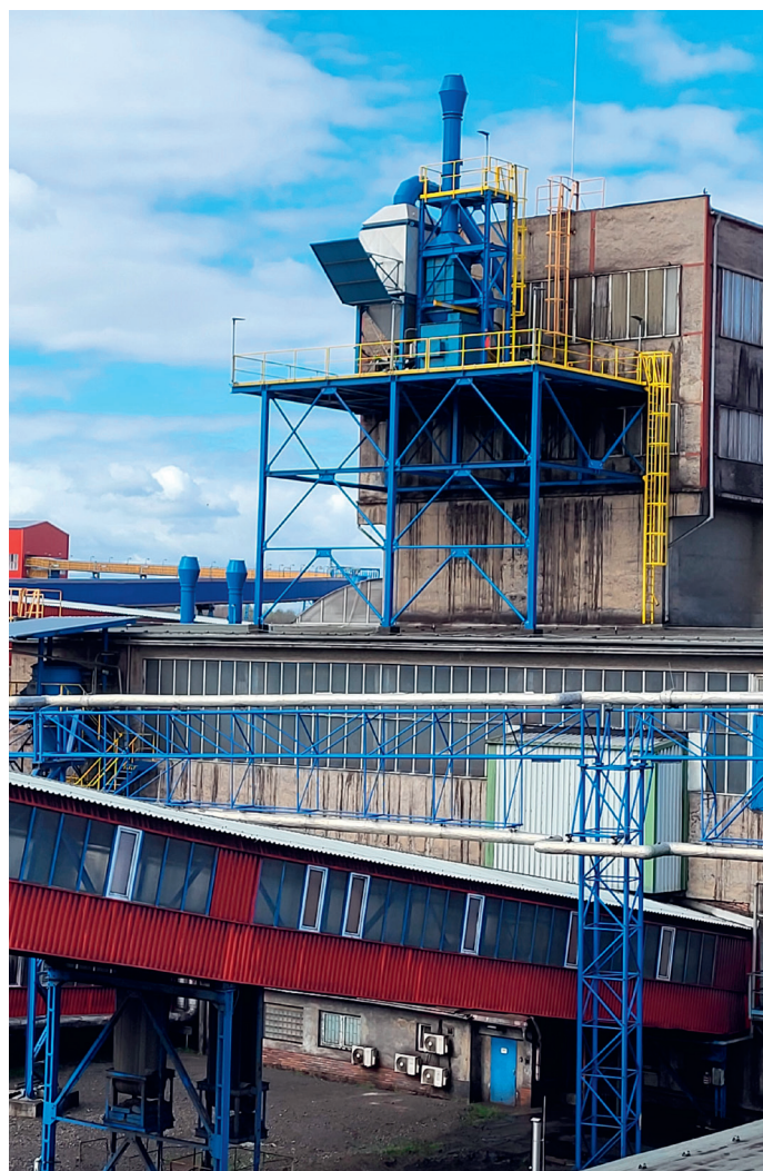
Obr. 7: Umístění nové technologie s instalovaným jímačem. [4]
